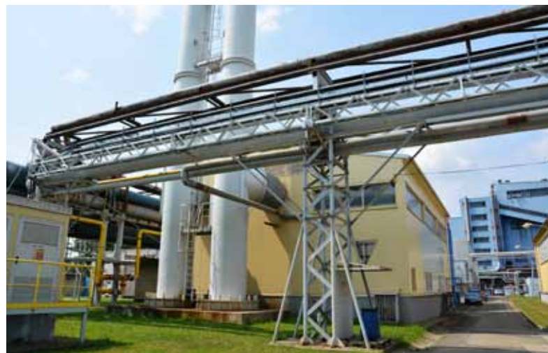
Špičkový zdroj byl zapojen také do soustavy v Teplárně Přerov
