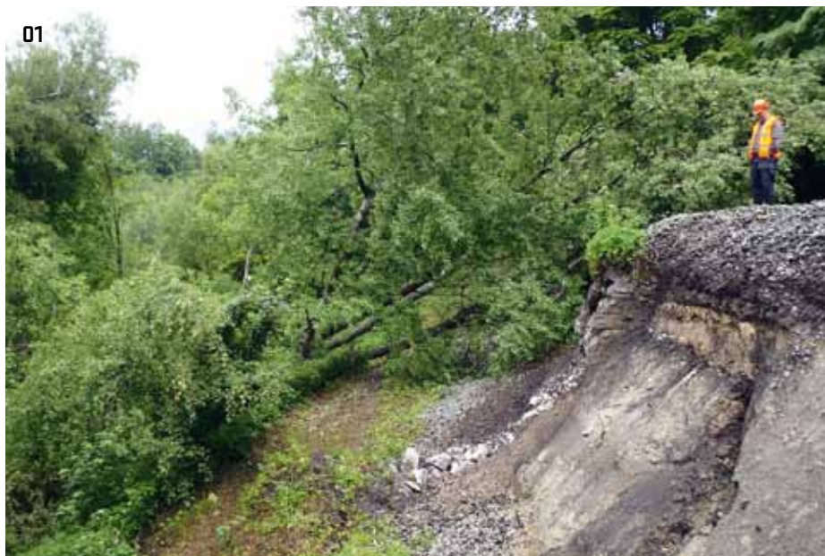
01 &gt; Sesuv půdy na trati v úseku Rynoltice–Křižany v červnu 2013
