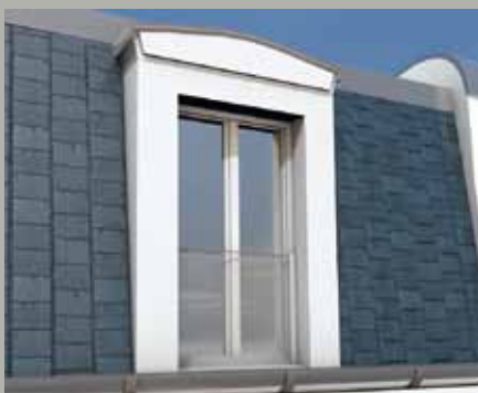
Ochranné zábradlí ukotvené do okenního profilu
