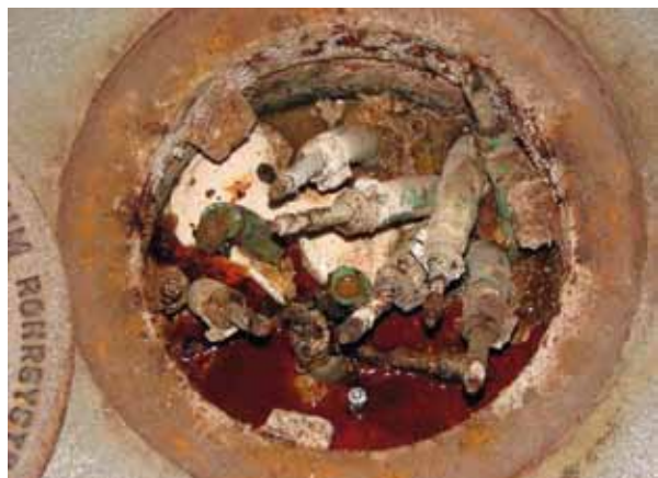
Šachta kontrolního systému dvojité sektorované hydroizolace zaplavená vodou. Kde je asi vada?
