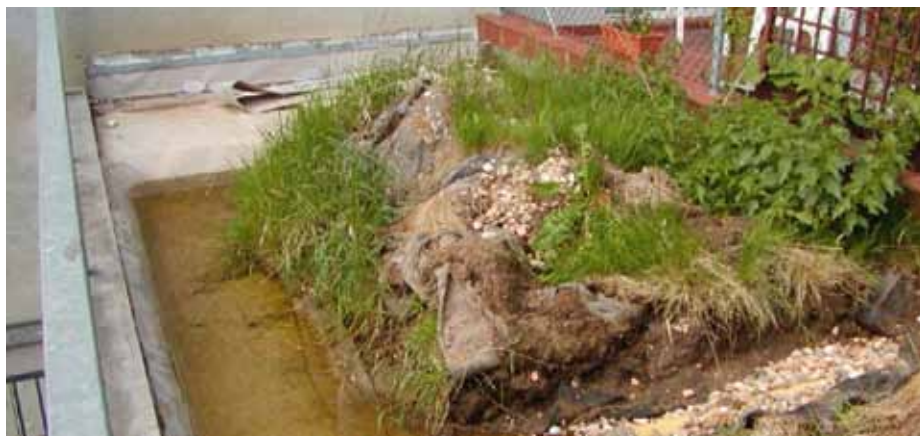
Zřejmě zde existuje zatížení zadržanou vodou ve vegetační střeše (NNV5). Návrhové namáhání podle tabulky 2 směrnice bylo o stupeň nižší.
